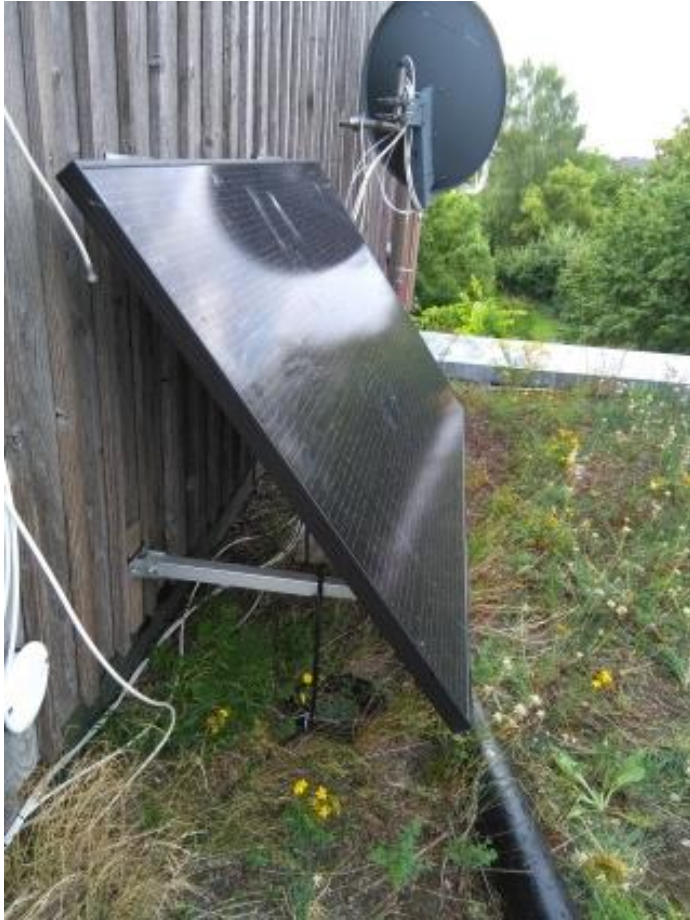
Modul - schräg an Hauswand befestigt
